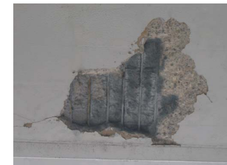
34年後 : 浮き・はく離・鉄筋腐食
