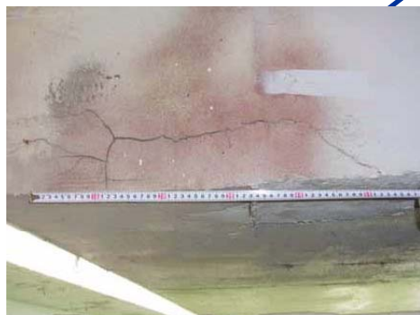
30年後 : 桁のひび割れ
