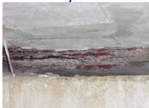
30年後 : 桁の鉄筋腐食
