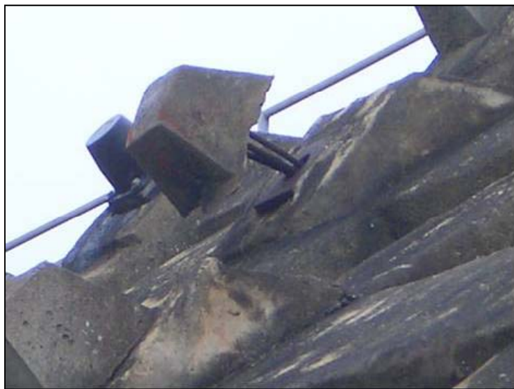
アンカー頭部の腐食・破損
