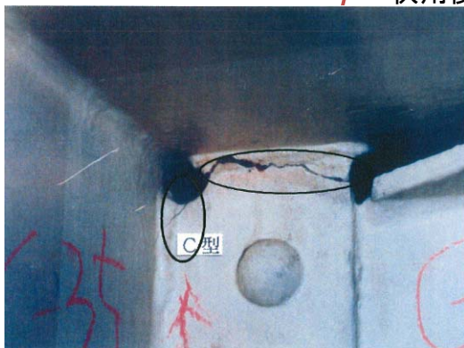
15年後 : 対傾構取付け部のき裂
